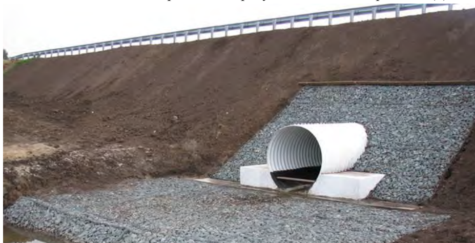
Рисунок 1 – Недостаточное укрепление откоса земляного полотна
