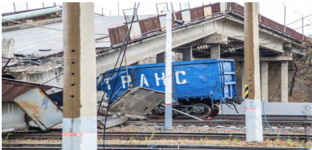
Рисунок 1 – Обрушение двух пролетов в связи с коррозией арматуры ригеля.
