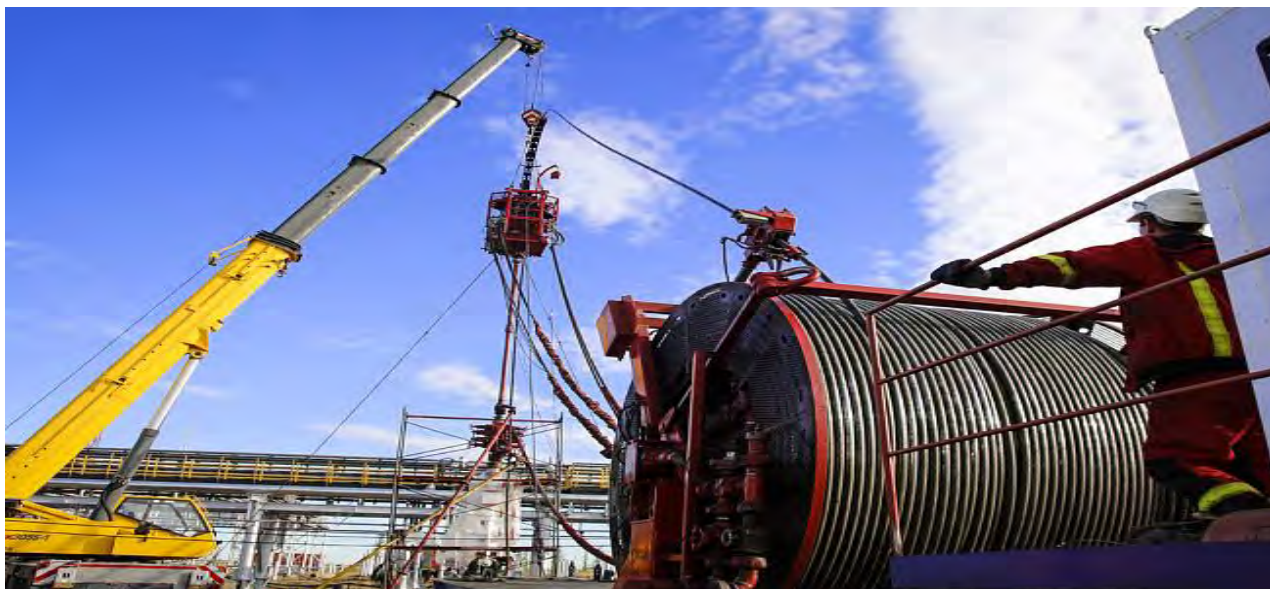
Рисунок 1 – Колтюбинговое оборудование, которое расположено на барабане самоходной технике
