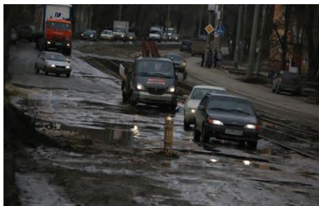
Рис. 1. Состояние дорог ул. Огородная.
