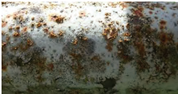
Рисунок 1 – Начальное состояние исследуемого образца трубы, поврежденного биокоррозией
