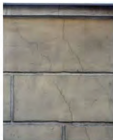
Фото №34. Фасад в осях 1-9/А. Осадочные трещины в уровне первого этажа до 1-2 раскрытия до 2 мм.
