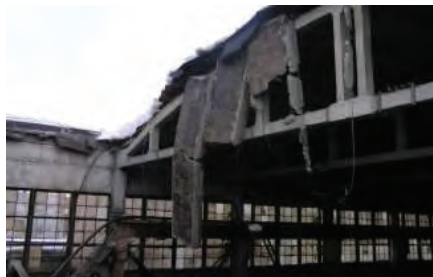
Рисунок 1. Раскрытие трещин в бетонных конструкциях.
