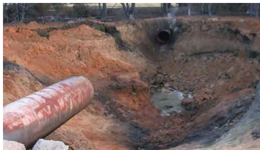
Рис. 2, Разрыв сильный газпровода.
