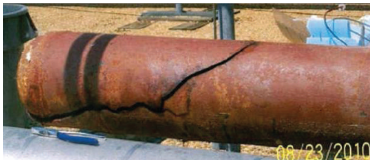
Рис. 3 – Повреждение аммиачного трубопровода в результате гидравлического удара на холодильной установке холодильника компании «Millard Refrigerated Services Inc.» в городе Теодор (штат Алабама, США) [6]
