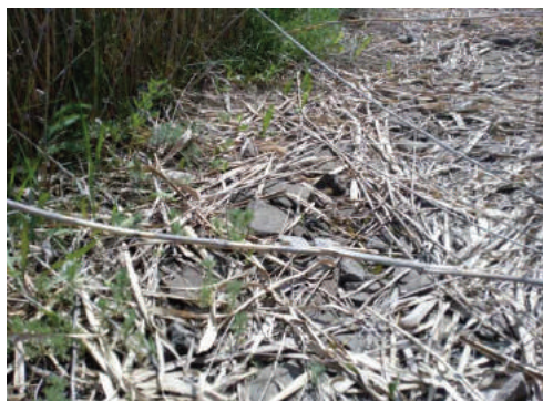
Рисунок 2. Крепление верхового откоса плотины (замыто)
