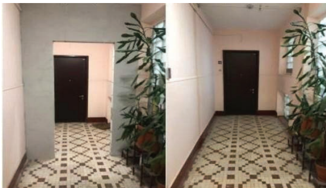
Рис. 1. Пример незаконной перегородки в холле многоквартирного дома
