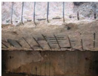
Рис. 2. Взрывное растрескивание, обнажение арматур (преднапряженных)
