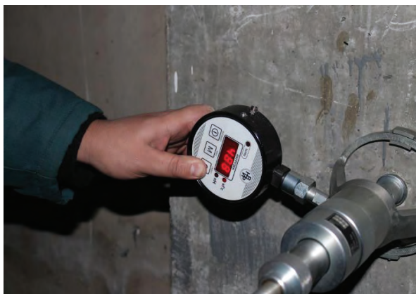
Рисунок 4 – Проведение измерения прочности разрушающим методом монолитной диафрагмы жесткости на объекте
