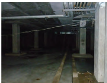
Рисунок 2 – Затопление подвального помещения объекта грунтовыми водами
