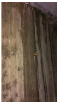
Рисунок 3 – Протечки грунтовых вод в подвальном помещении объекта
