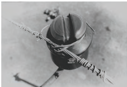
Рисунок Обрыв вязальной проволоки и износ провода в месте крепления к штыревому изолятору в результате воздействия ветровых и гололедных нагрузок
