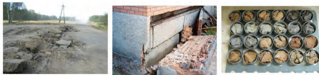
Рис. 1. Вид образцов набухающих глинистых грунтов, а также деформаций сооружений в процессе реализации явления набухания
