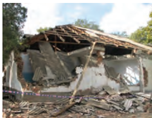
Рисунок 2 – Общий вид поврежденного здания в результате сейсмического события, произошедшего в Чеченской Республике в октябре 2008 года
