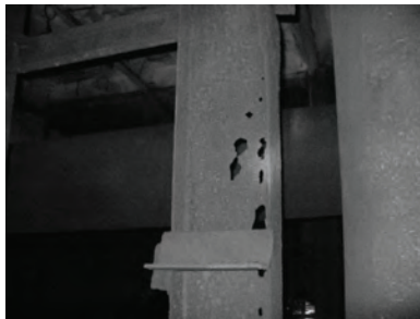
Рисунок 6 - Коррозия стальной стойки
