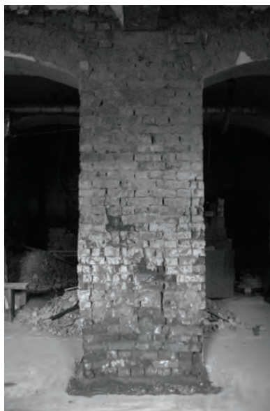
Рисунок 2 – Трещины и вздутия
