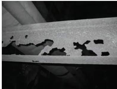
Рисунок 5 - Коррозия стальной балки
