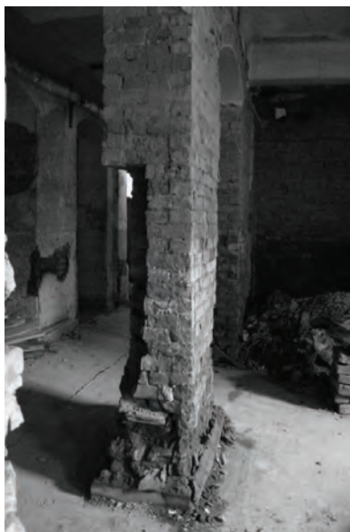
Рисунок 1 – Разрушение кирпичной кладки простенков
