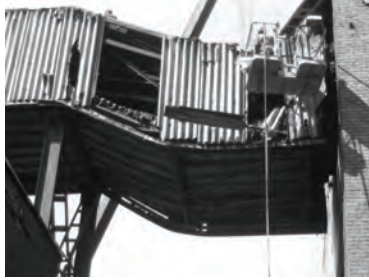
Рисунок 4 - Деформации стальных конструкций из-за коррозии элементов
