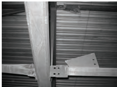
Рисунок 1 - Дефект монтажа стальных конструкций
