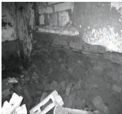
Рисунок 3 – Разрушение кирпичной кладки наружных несущих стен
